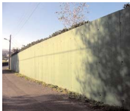
Muro da vivenda de José Maria Campo que incumpe a ordenação municipal. Foi definido polo arquitecto municipal como 'tradicional' para nom ter que derrubá-lo
