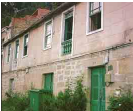
Residência deteriorada da paróquia de Friera (Crescente) em que está recenseada Ana Llorca Maneiro, a interventora de Ponte Areias
