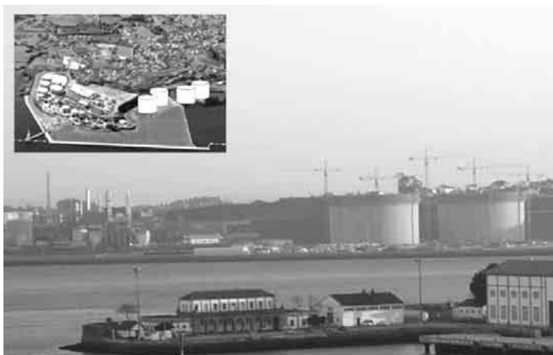
Visão geral dos dois tanques já levantados e parte do complexo petro-químico. Na parte superior esquerda vemos o aspecto de Ponta Promontório, incluindo os dois novos tanques previstos e as demais empresas já instaladas.
